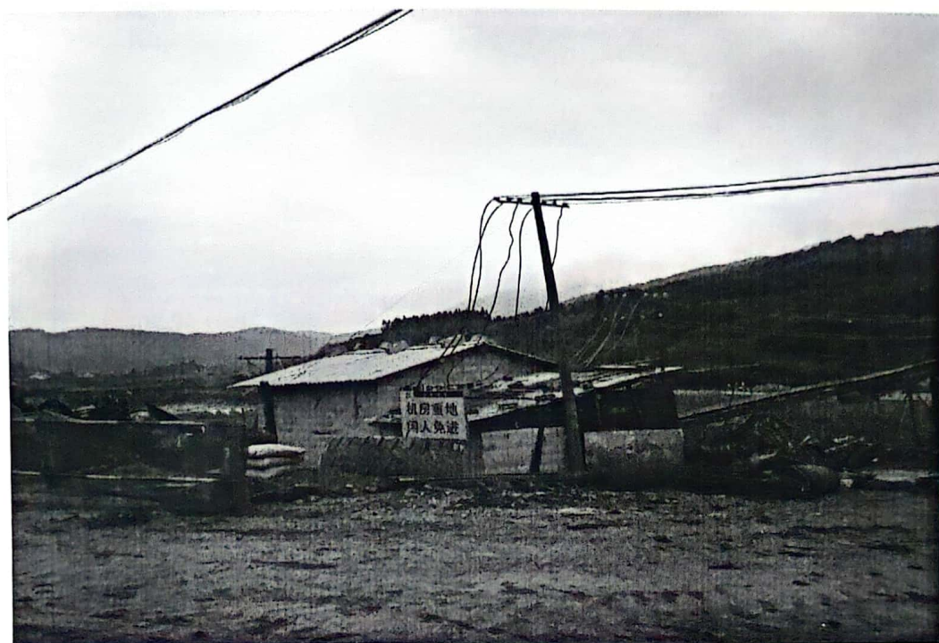
图照四：整理后的主坝石料场施工电线路
