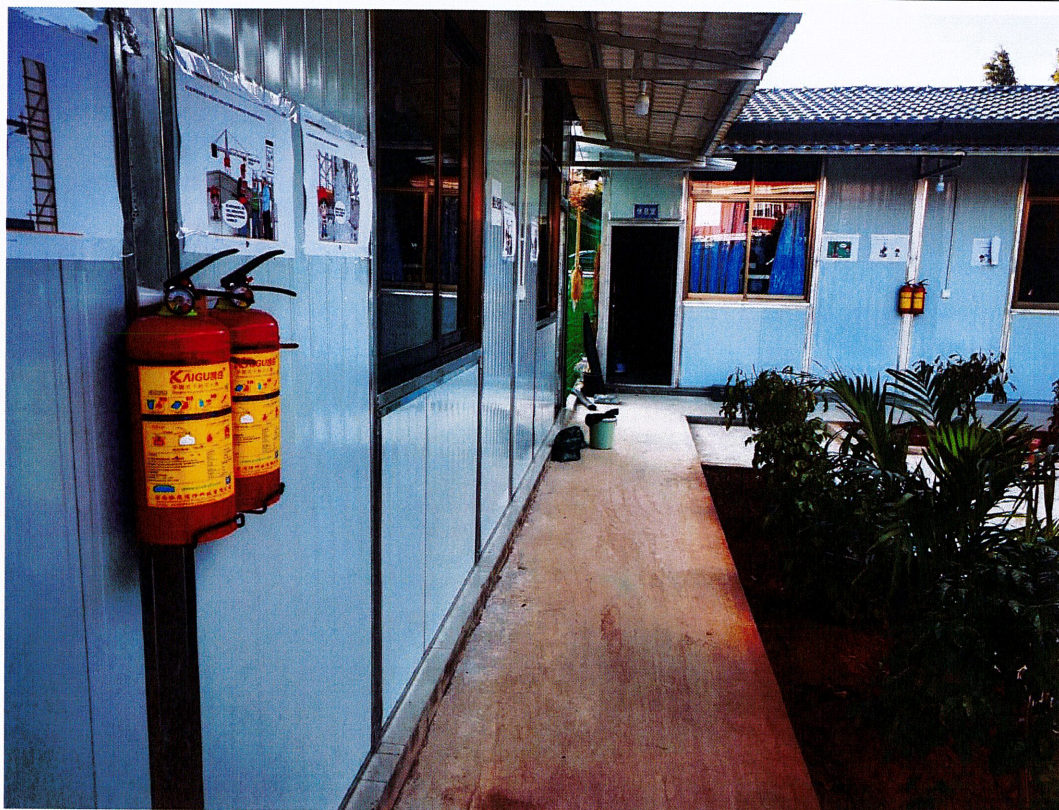
项目部未配备灭火器整改后
